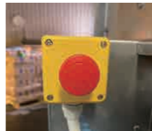
緊急停止ボタン
